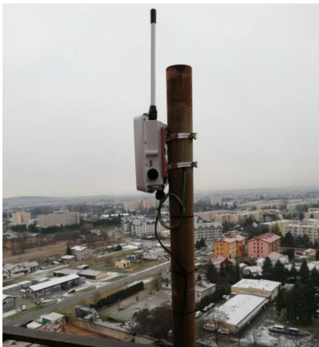
Rys. 6. Antena BTS (Kerlink) zamontowana na kominie krośnieńskiej ciepłowni miejskiej.
